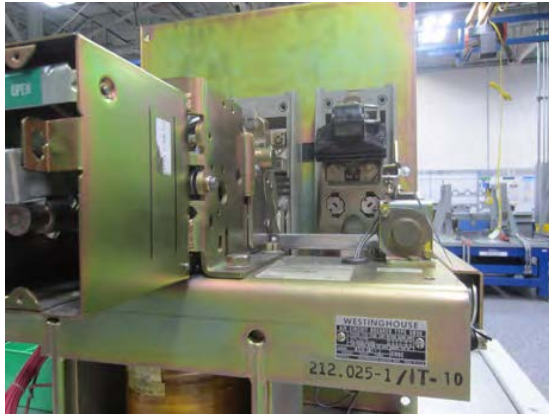
Breaker without the STA
